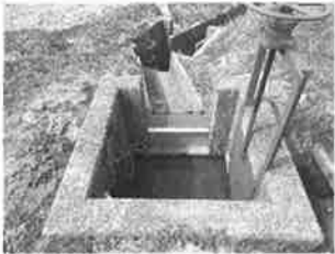
中田ステンレスゲート設置(東江地区)
