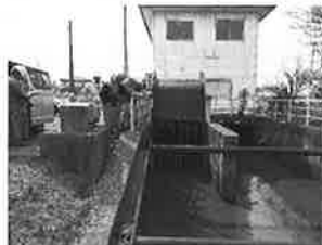
排水機場試運転(長嶺地区)
